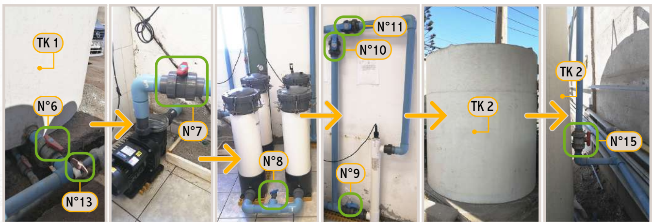
Figura 28. Procedimiento de distribución de agua de mar a TK2, raceway invernadero, B400 y B1000
