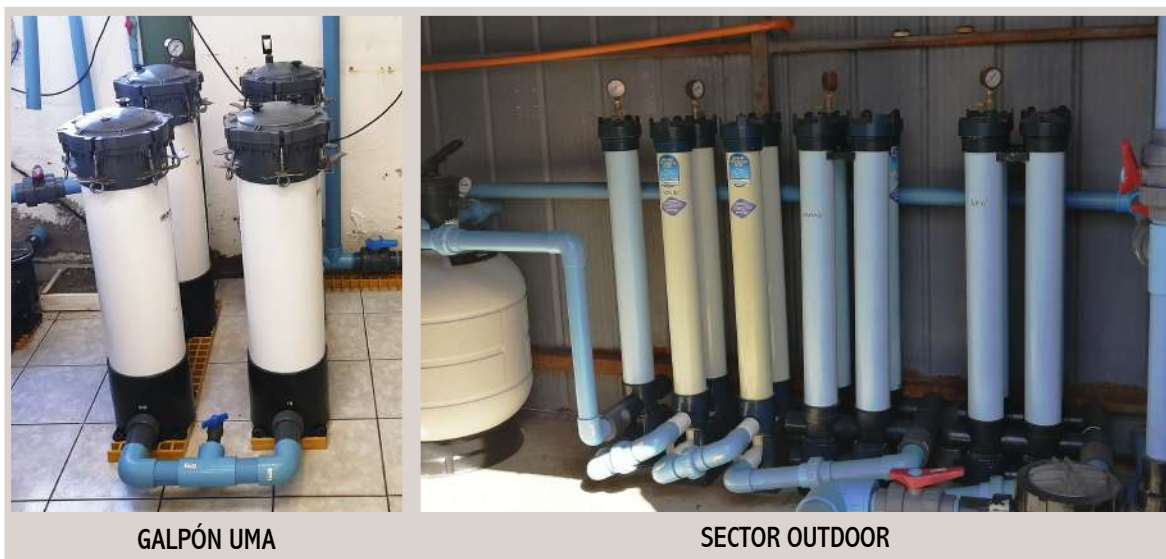
Figura 35. Sistemas de filtración de agua de mar
