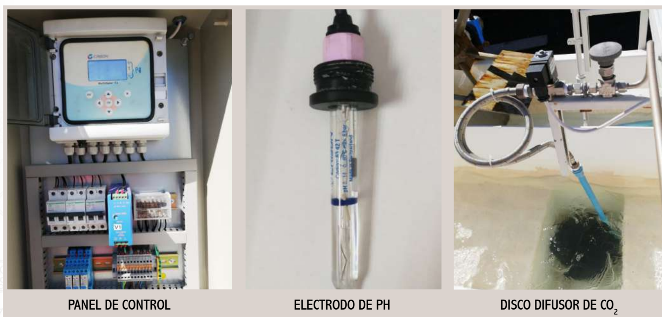
Figura 38. Sistema de control de pH mediante inyección automática de CO 2
