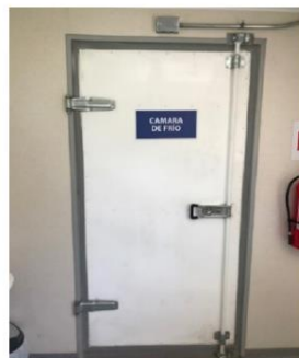
Cámara de frío (puerta interior)
