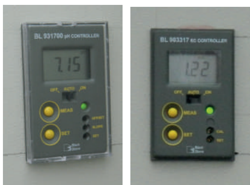
Figura 22. Panel de Minicontroladores de pH y CE.
