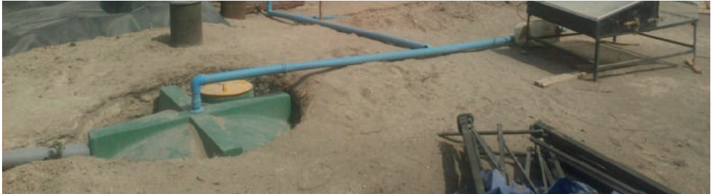
Figura 7. Estanque receptor del agua residual urbana tratada proveniente de la planta de tratamiento que ha pasado por el sistema de desbaste y decantación implementado por el proyecto. Pozo Almonte
