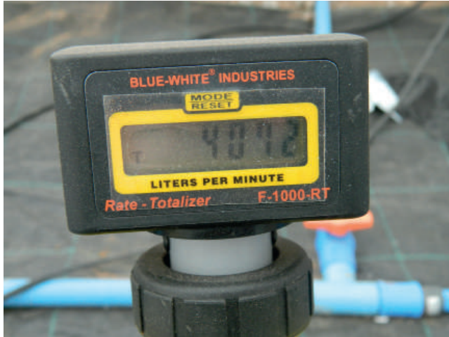
Figura 23. Medidor de caudal en línea del volumen de agua.
