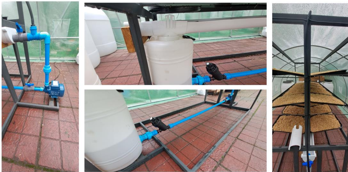
Figura 5. Sistema de riego
