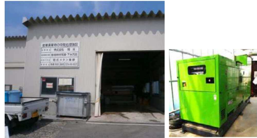
Instalaciones de cogeneración de biogás
