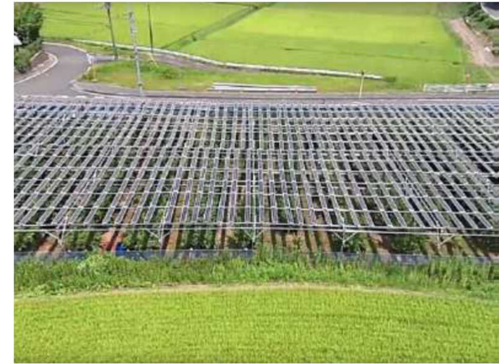
Vista exterior de la instalación
