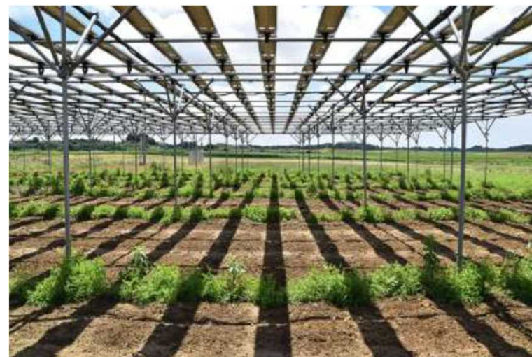
Vista exterior de la instalación
