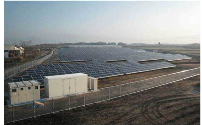
Vista exterior de la instalación
