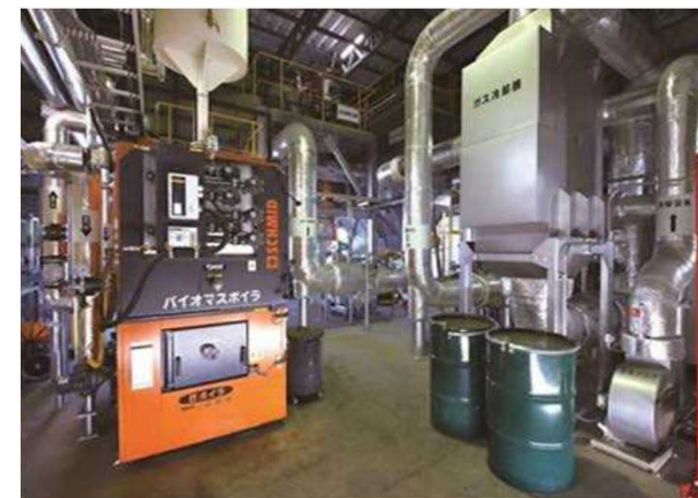
Calderas de biomasa de madera
