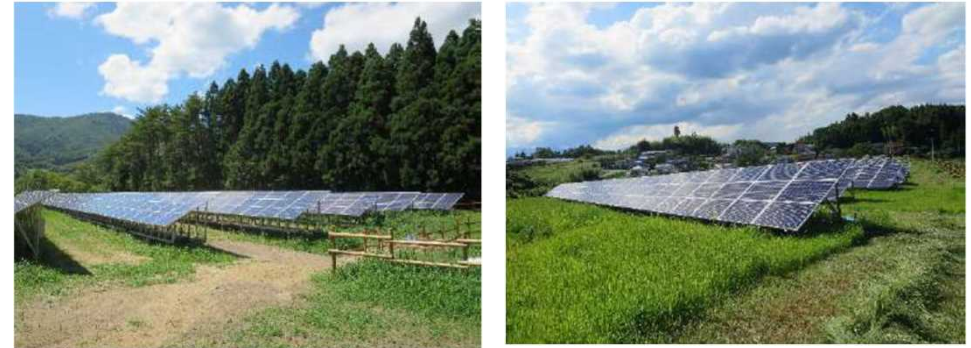
Vista exterior de la instalación
