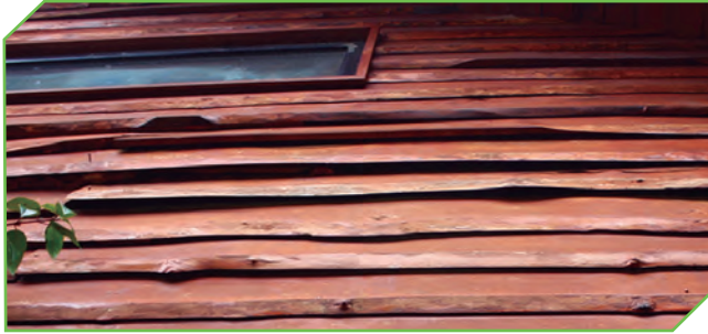
Figura 19. Incorrecto revestimiento horizontal.
