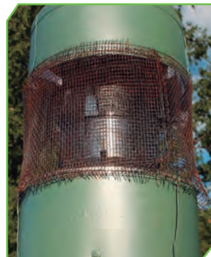
Figura 16. Chimenea con protección de malla de alambre fino.
