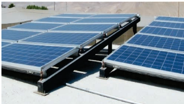
Figura 2. Ejemplo de generador fotovoltaico, Azapa km 21.
