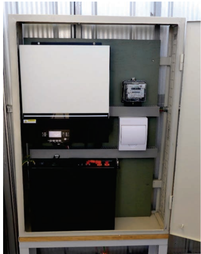
Figura 3. Inversor con regulador de carga incorporado y batería de litio con medidor electrónico monofásico. Módulo de validación de Alto Azapa, km 34.
