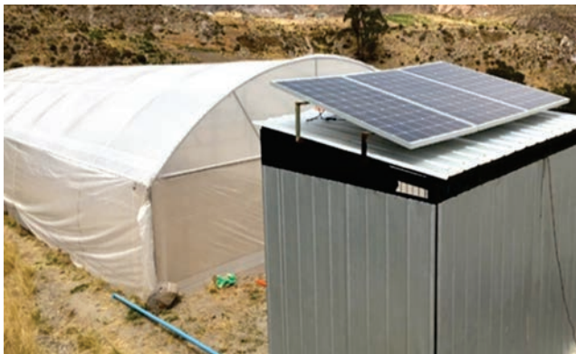
Figura 1. Sistema fotovoltaico para invernadero en localidad de Putre.
